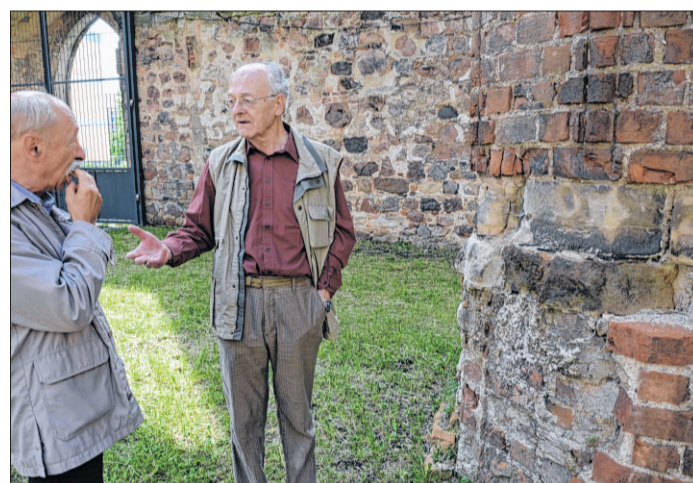
Förderkreisvorsitzender Walter Tharan zeigt Gebietskonservator i.R. Theo Lösser (l.) das Problem der geschädigten Pfeiler in der Nicolai-Kirche. Foto: Helmut Rohm
